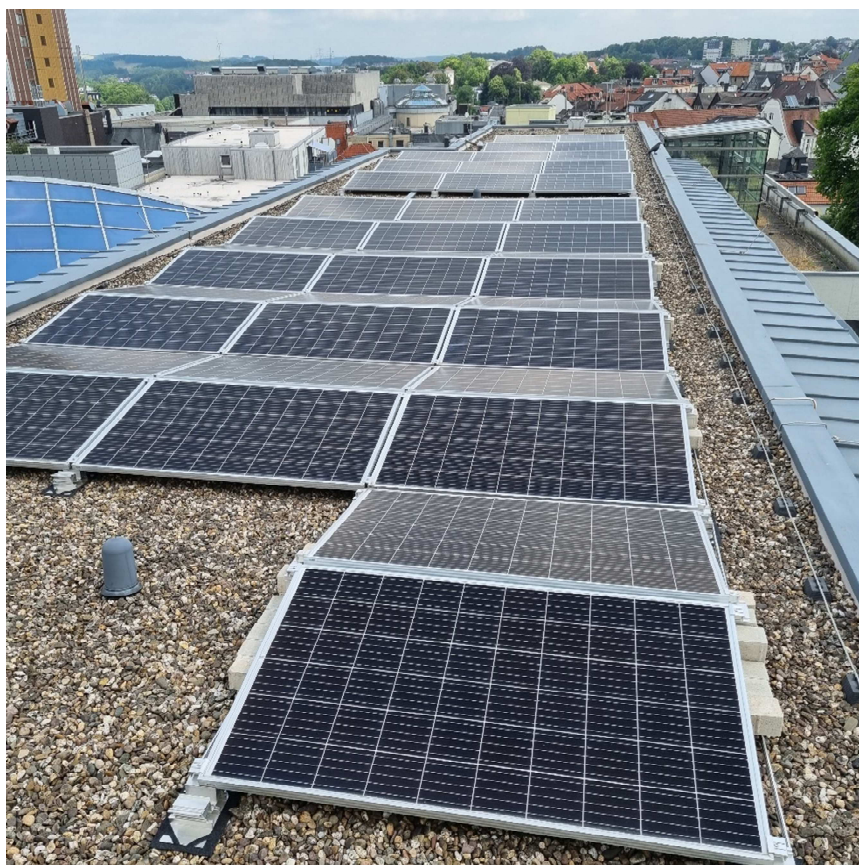
Teil der neuen Anlage auf dem Dach der in der Lüdenscheider Sparkassen-Hauptstelle, Sauerfelder Straße 9
